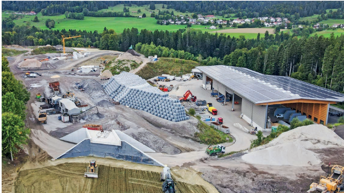
Les travaux préparatoires à la déviation de la route cantonale ont débuté l'an dernier. On aperçoit Le Fuet en arrière-plan.
